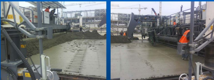
Укладання цементобетонної суміші після першого бетоноукладача SP-1500 наступний шар суміші цементобетонну укладається другим бетоноукладачем SP-1500;
